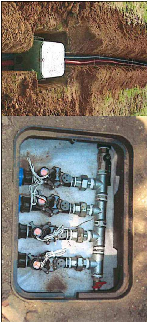
POZZETTO CON ELETTROVALVOLE IN FUNZIONE
